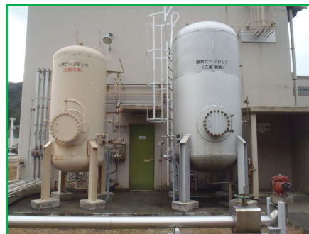
【水素・酸素サージタンク】
