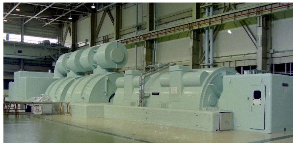
タービン発電機（タービン建物3階）
