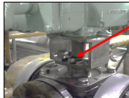
復水器細管洗浄系統弁のグランド部にじみ
