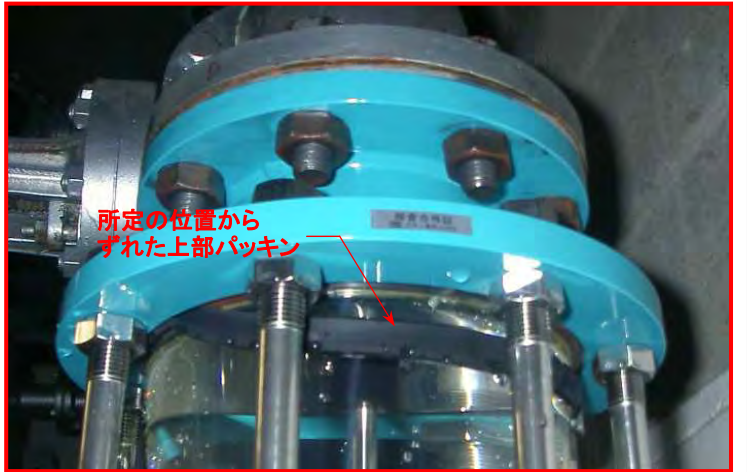
[流量計上部(漏えい箇所)状況]
