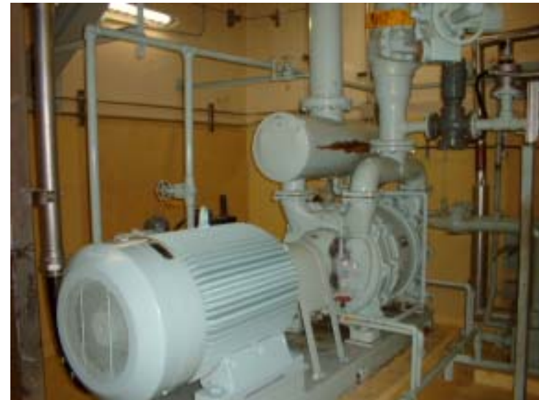
起動用真空ポンプ
