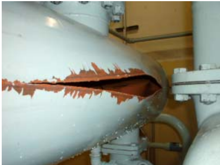
ドレンセパレータ(拡大)
