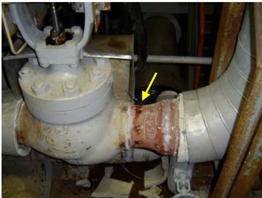
漏えい部位の写真
