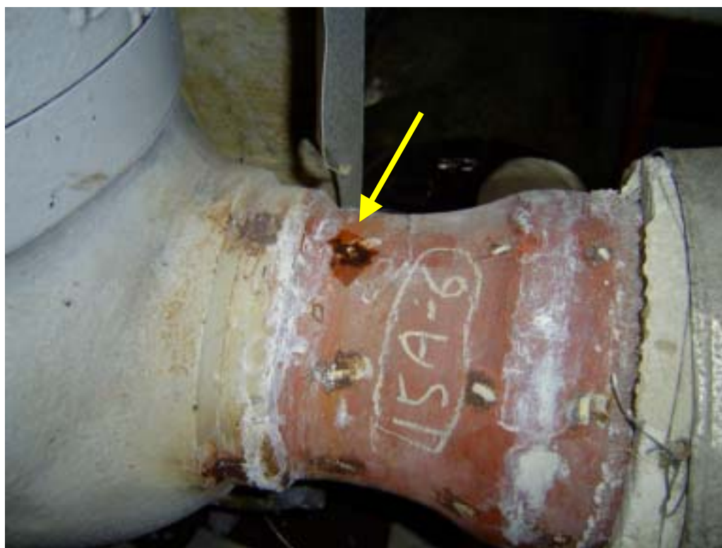
漏えい部位の写真（拡大）
