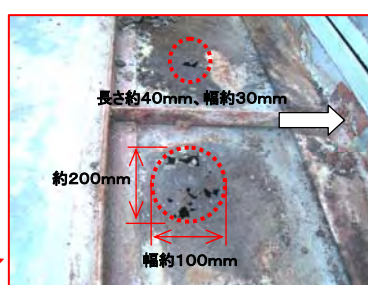
＜腐食状況（代表例）＞
