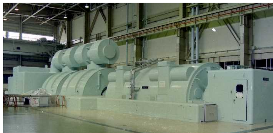
タービン発電機（タービン建物3階）
