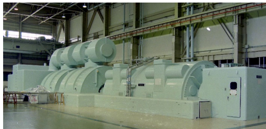
タービン発電機（タービン建物3階）
