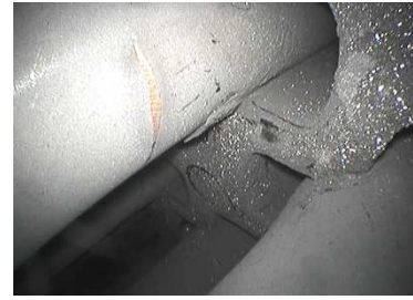
(A-SG第6管支持板のきずの状況)
