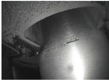
(A-SG第3管支持板のきずの状況)
