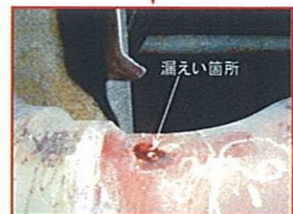
漏えい箇所拡大
