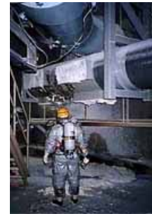
漏えい事故現場 (1995.12)
