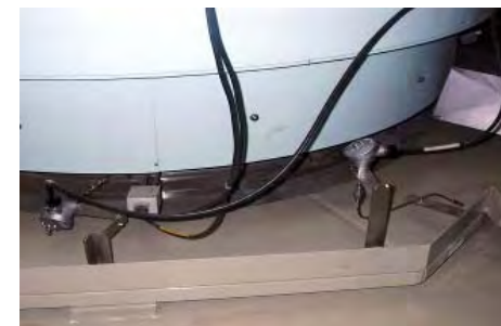
2次系コールドトラップ下部での設置状況
