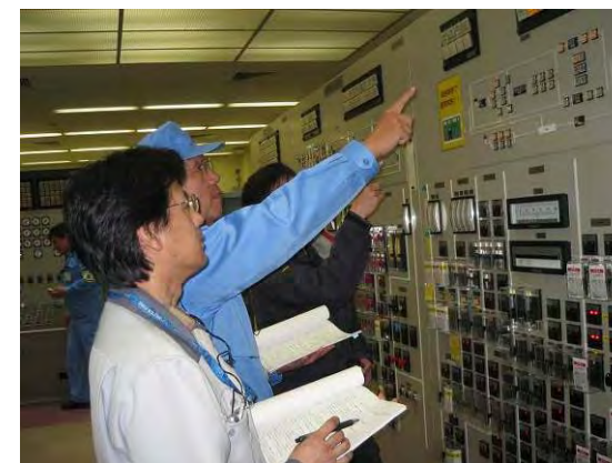
確認試験実施状況 (中央制御室での警報確認)
