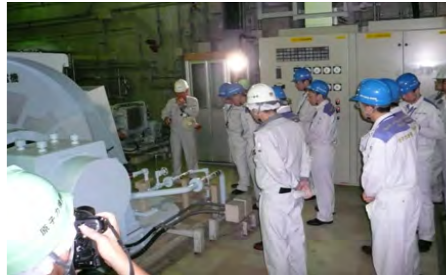
非常用ディーゼル発電機
