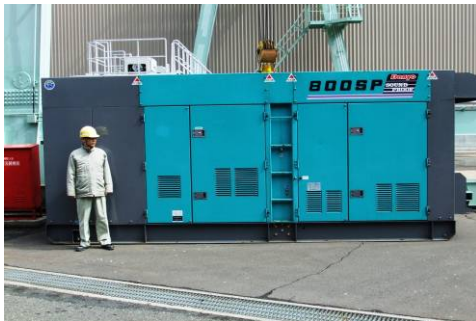
【800kVAディーゼル発電機】
