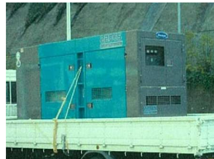
【220KVAディーゼル発電機】
