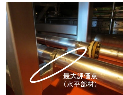
地震動解析評価の結果、基準値を上回っているが、保安院による現地調査の結果、有意な損傷は無いことを確認した。(写真:配管サポート)
