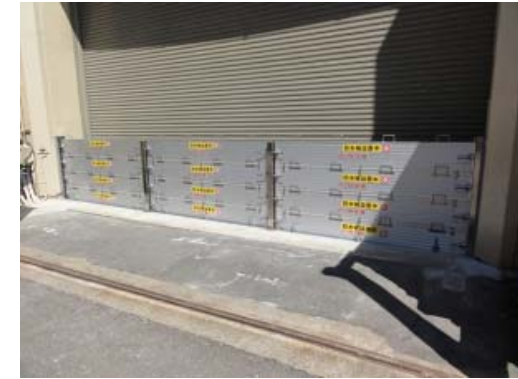
(美浜2号機使用済燃料ピットシャッター前)
