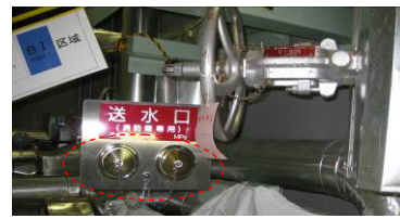
非常用復水器貯蔵タンク行き送水口 (消防ホースを直接接続可能)
