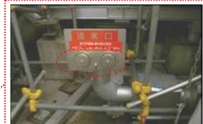
原子炉建屋 消火栓用送水口 (消防ホースを直接接続可能)
