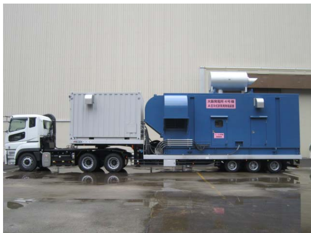
写真1-1 4号機空冷式非常用発電装置(A)
