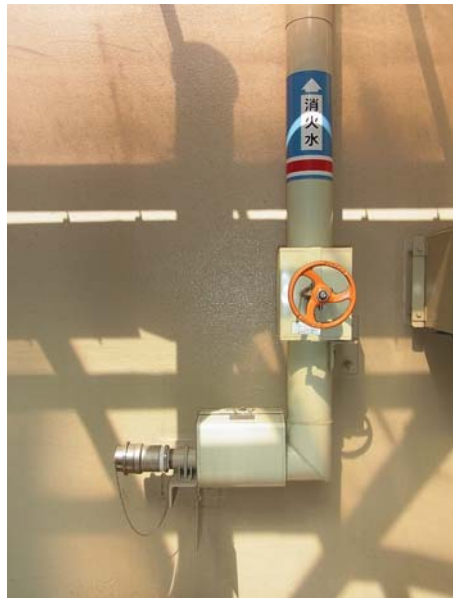
写真 2-3 消火水系統の消火水接続口（制御建屋 4 号機側）
