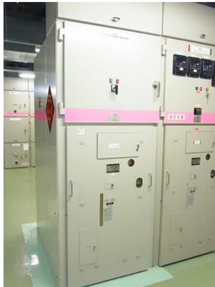
写真 1-3 高電圧開閉装置（空冷式非常用発電装置用のしゃ断器盤）
