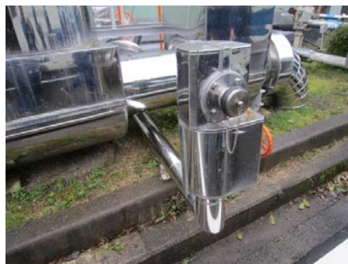
写真 1 1 - 2 タンク出口ホース接続口
