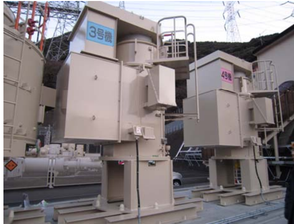
写真6 海水ポンプ予備モーター
