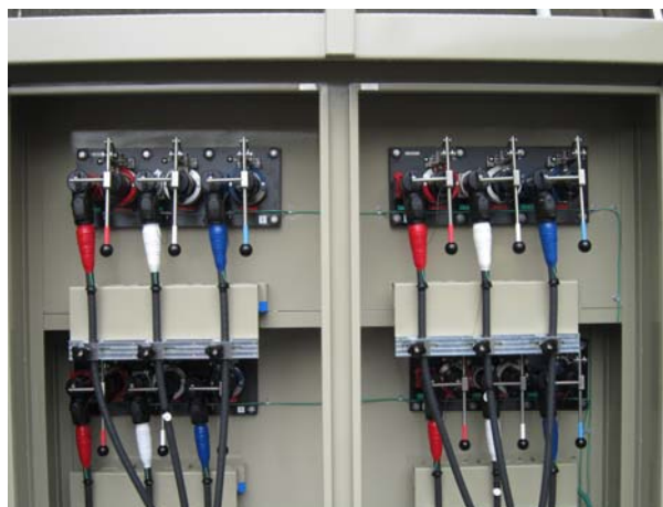
写真1-2 空冷式非常用発電装置接続盤
