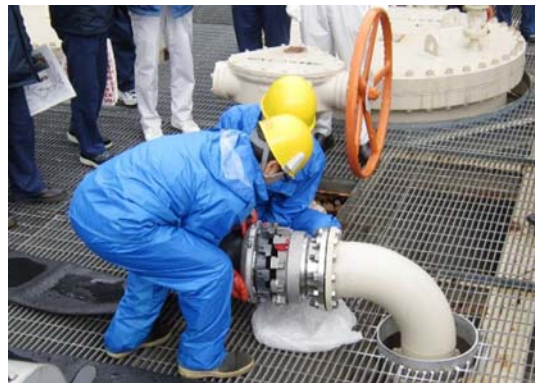
写真 2-2 海水ポンプ接続口 (海水ストレーナ出口)
