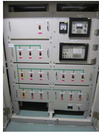
写真3-2 直流きでん盤 (負荷切り離しのしゃ断器)
