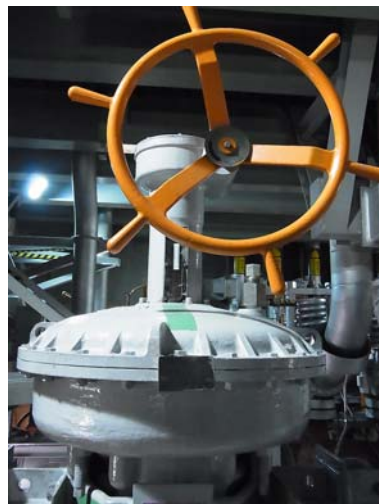
写真 5-2 主蒸気逃がし弁手動ハンドル
