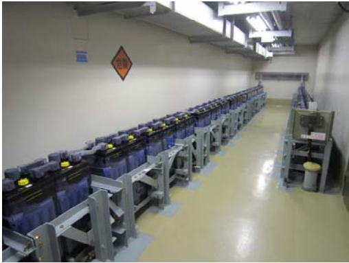
写真3-1 バッテリー室
