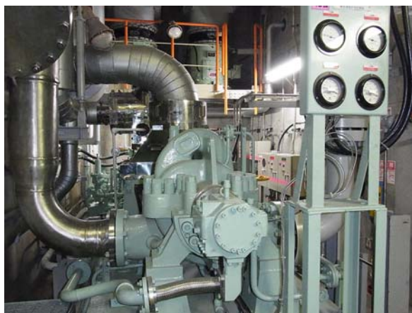
写真4 タービン動補助給水ポンプ外観
