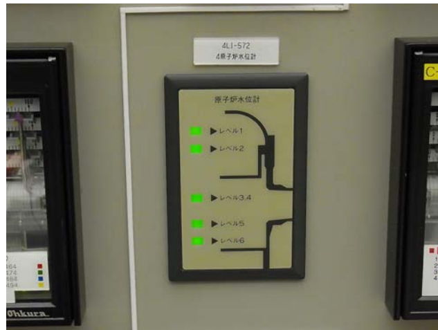
写真9 原子炉水位計（中央制御室）
