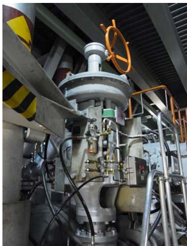
写真 5-1 主蒸気逃がし弁外観
