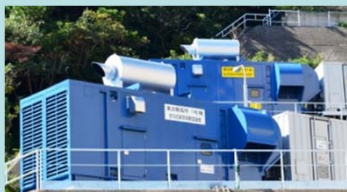
空冷式非常用発電装置
