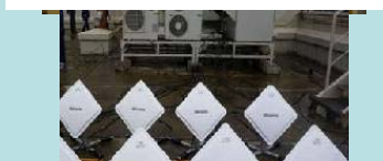
衛星電話(屋上アンテナ)
