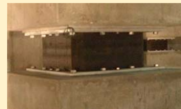
積層ゴム免震装置
