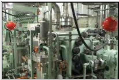
充てん・高圧注入ポンプ
