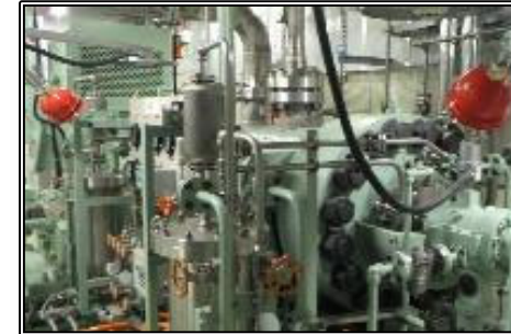
充てん・高圧注入ポンプ
