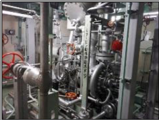
タービン動補助給水ポンプ°
