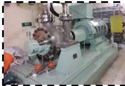
恒設代替低圧注水ポンプ
