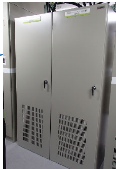
SPDSサーバー (伝送装置制御盤)外観
