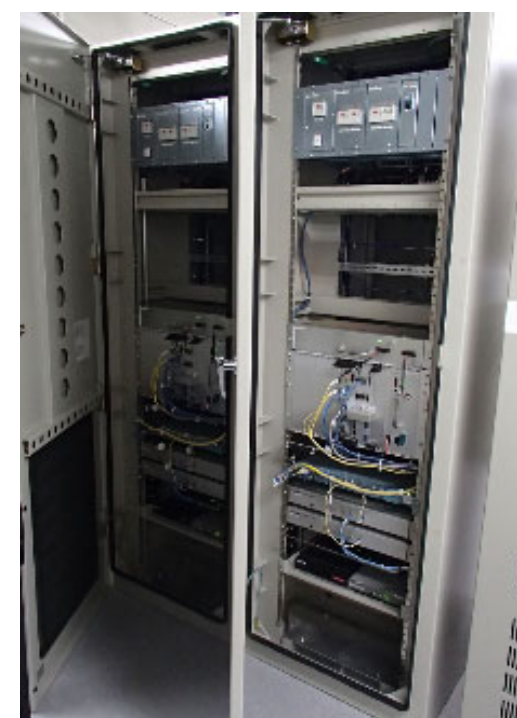
SPDSサーバー (伝送装置制御盤)内部
