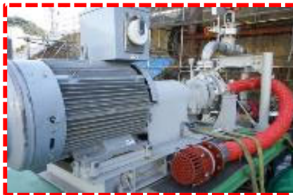
可搬式 代替低圧注水ポンプ
