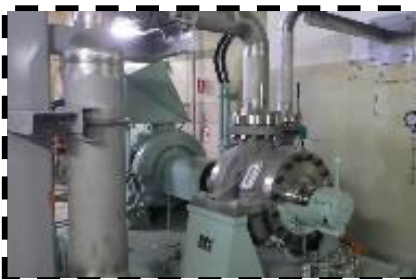
原子炉下部キャビティ 注水ポンプ
