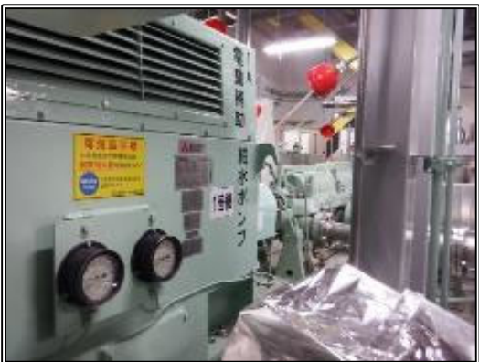
電動補助給水ポンプ°
