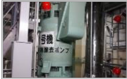
余熱除去ポンプ
